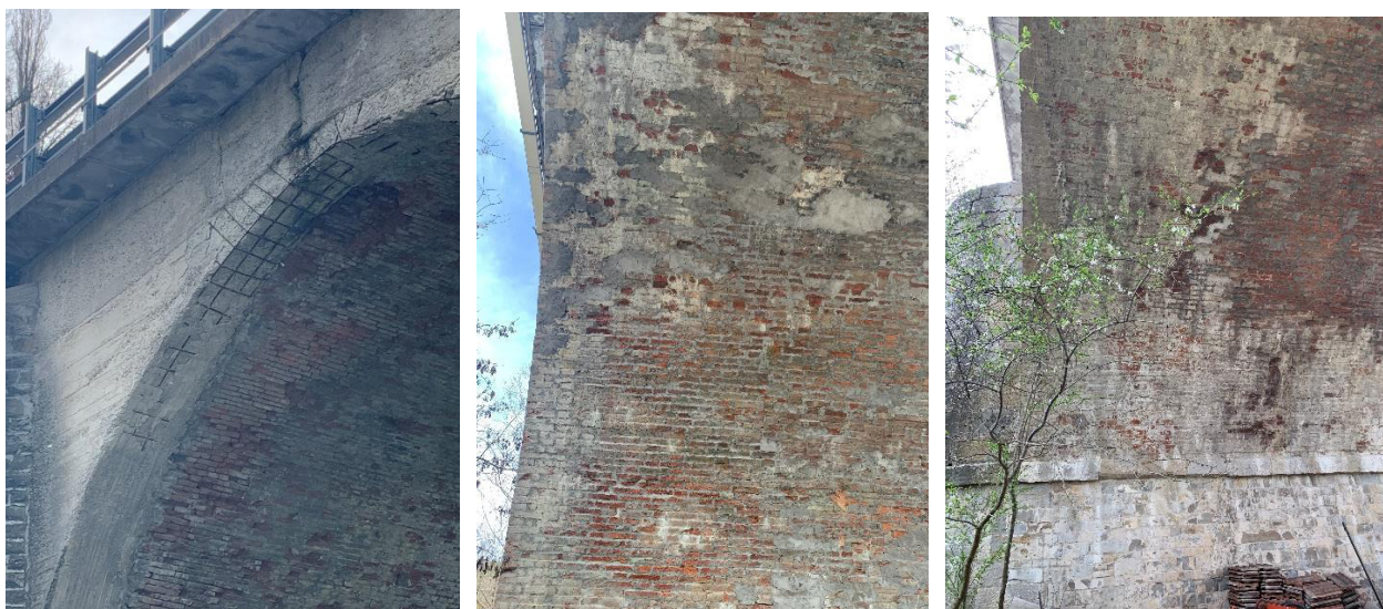
Quadro difettologico rilevato
